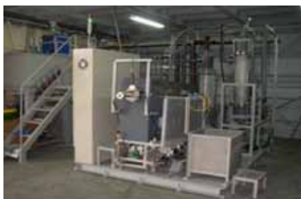
図-3 フロン破壊装置
